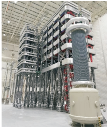
图1 张北工程中535 kV 混合式直流断路器
