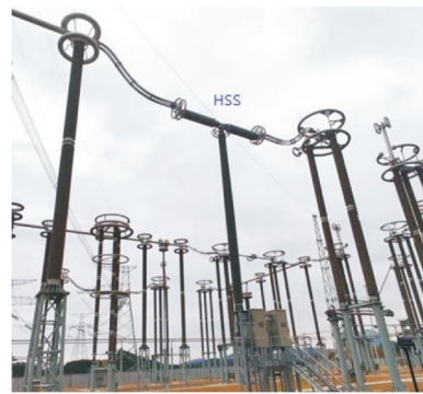
图2 多端柔直工程中运行的800 kV 高速机械开关 HSS
